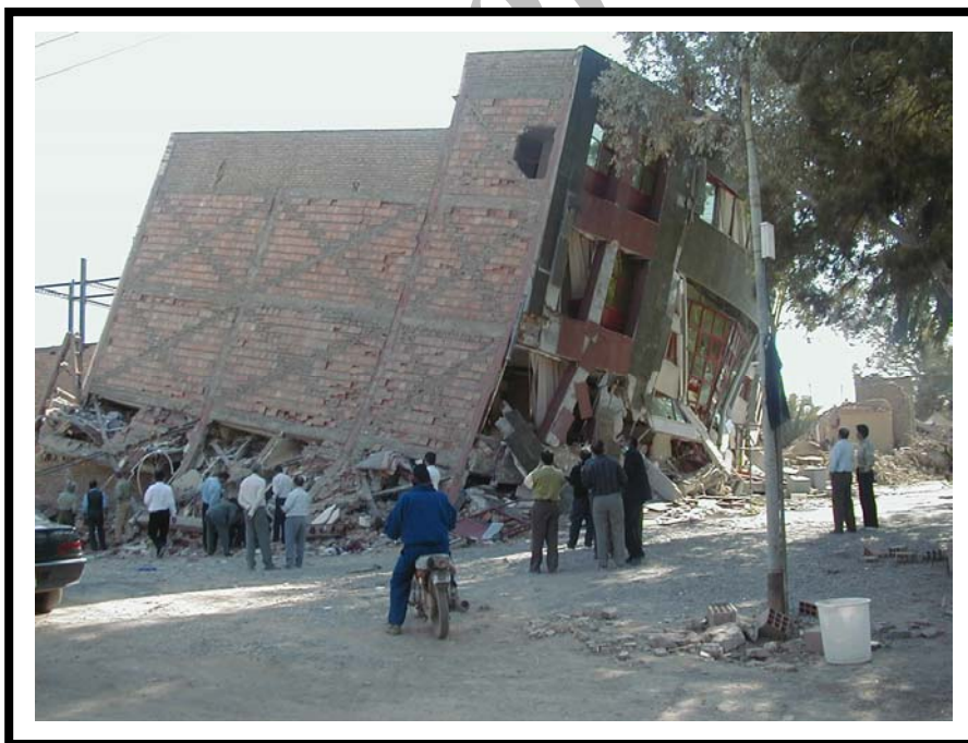
شکل ۲- ساختمان پنج طبقه نوساز در شهر بم که بر اثر زلزله تخریب شده است
